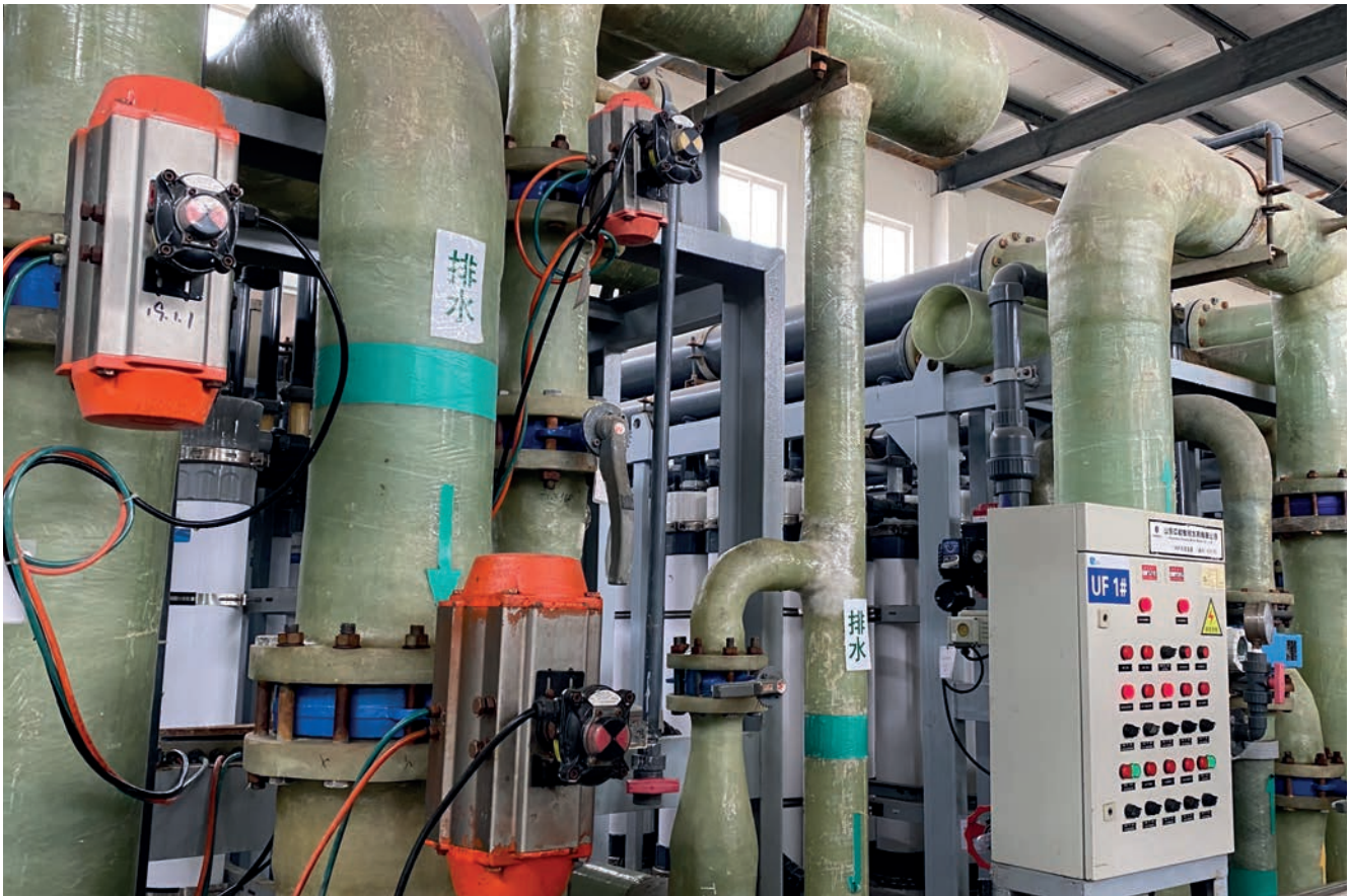
Der Nachhaltigkeit verpflichtet: Abwasser wird in einem Zweistufen-Hochleistungsfiltersystem zur Wiederverwertung aufbereitet.
